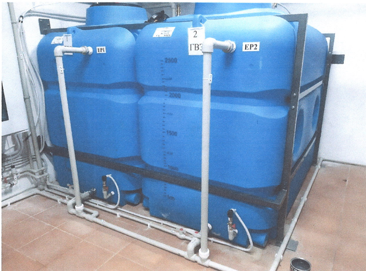
Оборудование системы обеззараживания
