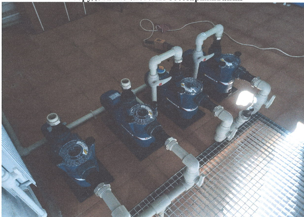
Оборудование системы обеззараживания
