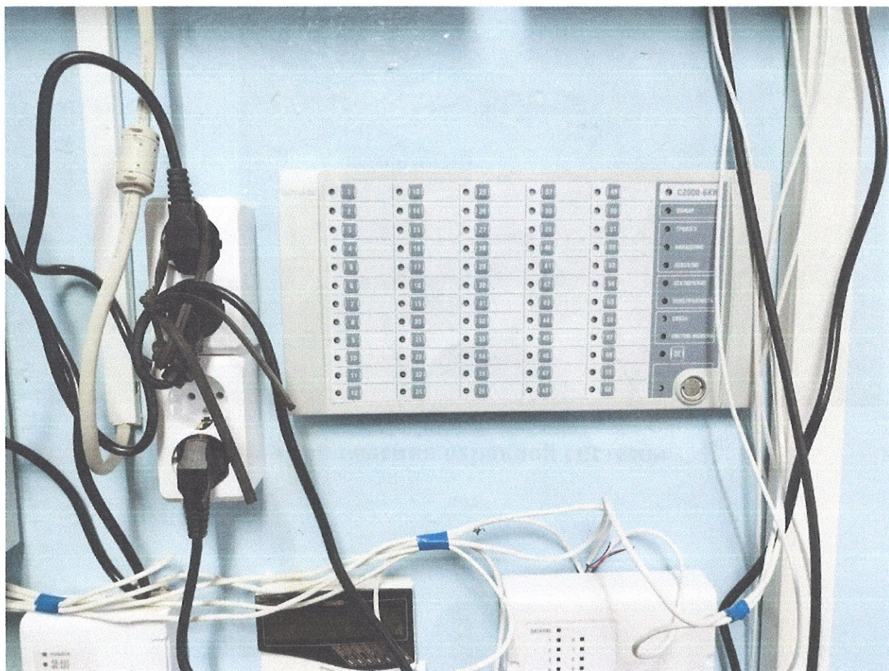
Пульт управления системы охранной сигнализации и охранной телевизионной с источником бесперебойного электроснабжения ТВЗ
