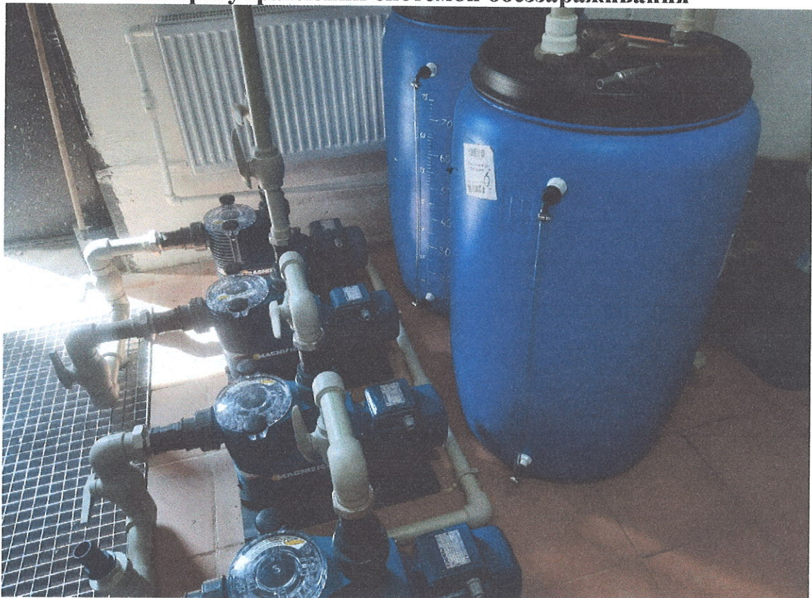
Оборудование системы обеззараживания
